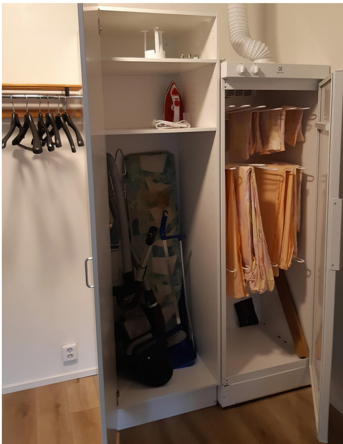
Kuva 11; Siivous- ja kuivauskaapit
